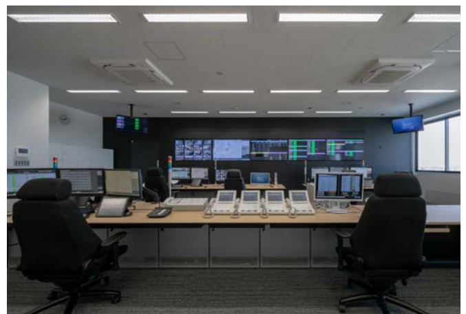
通信指令センター
