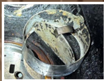
焼損した防火ダンパーを清掃した状態。 付近には多量の油脂等が付着している。
