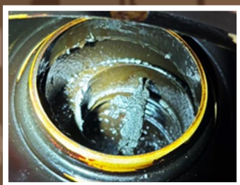
排気ダクト及び防火ダンパー 多量の油脂等が付着し、作動に支障がある。
